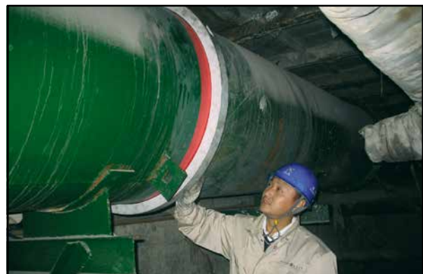
40" Rings an einer Förderleitung in China (Stahlindustrie)
